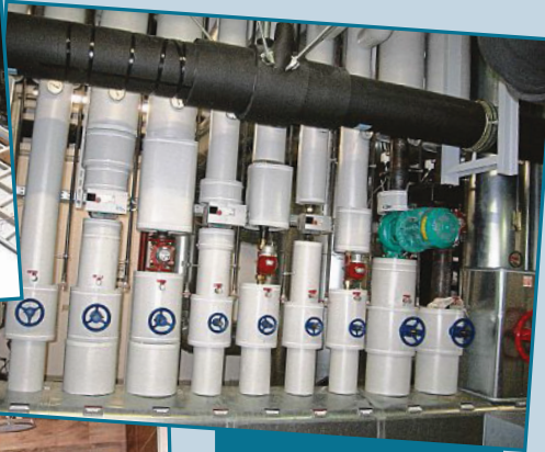
Eine der Firmenleistungen: Blick in die Technikzentrale im GEP
